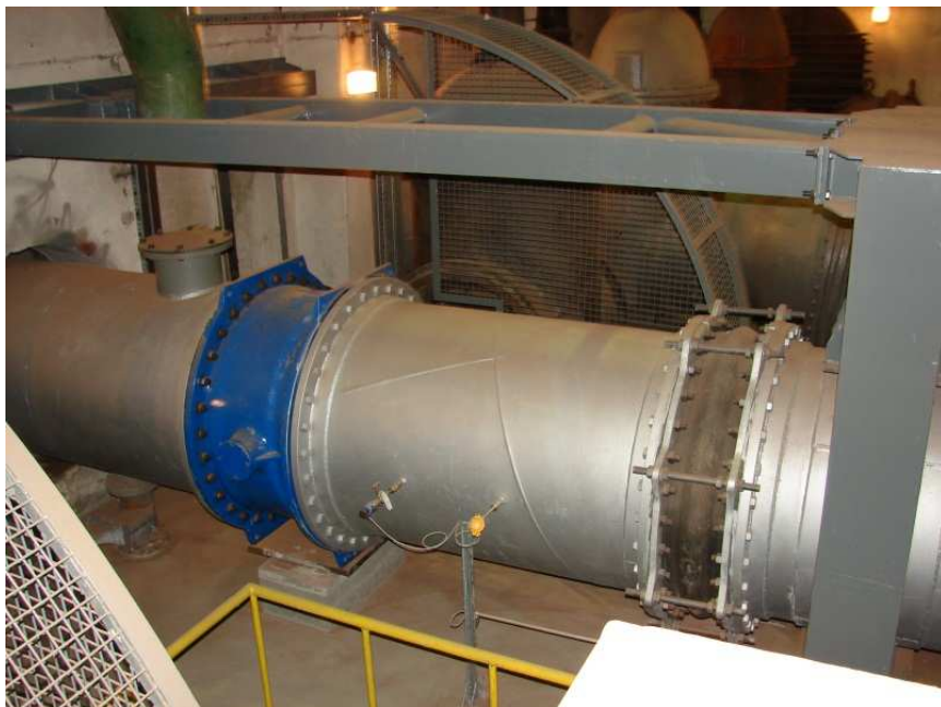
Zdjęcie nr 2. Armatura po modernizacji EKN DN 1200 z HB-HV Pompowni Centralnej ZE PAK - El Konin
